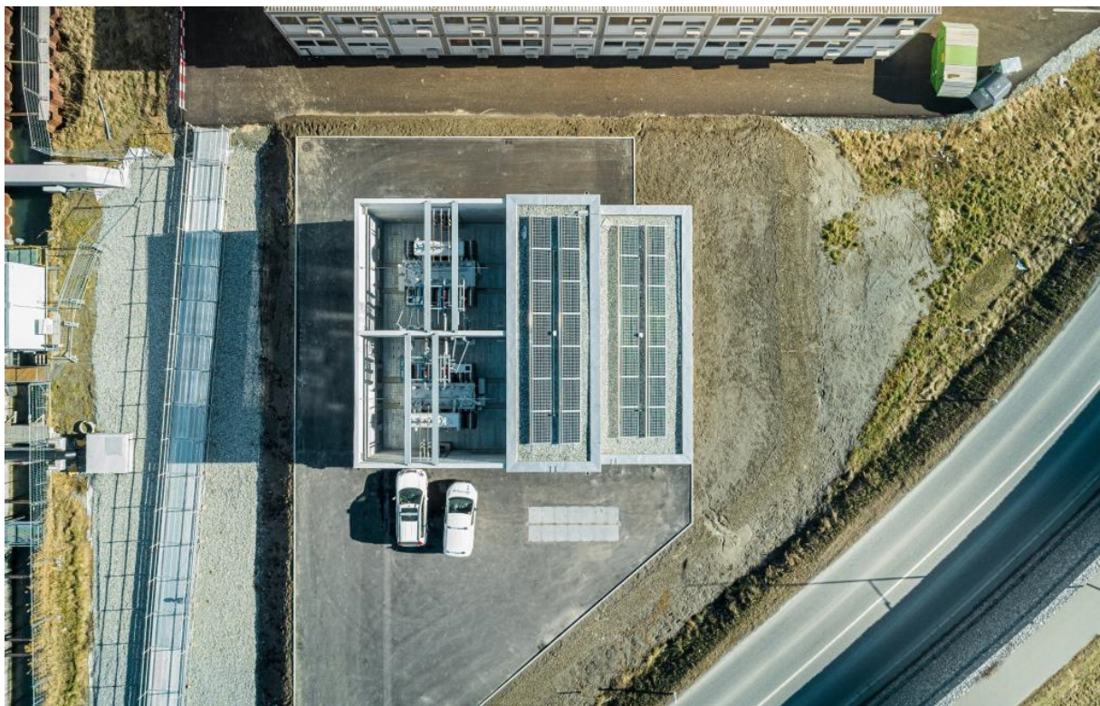
Neues Unterwerk in Visp aus der Vogelperspektive
